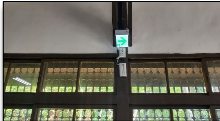
消防設備配管配線
