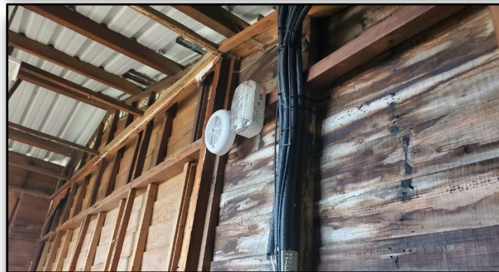
消防設備配管配線
