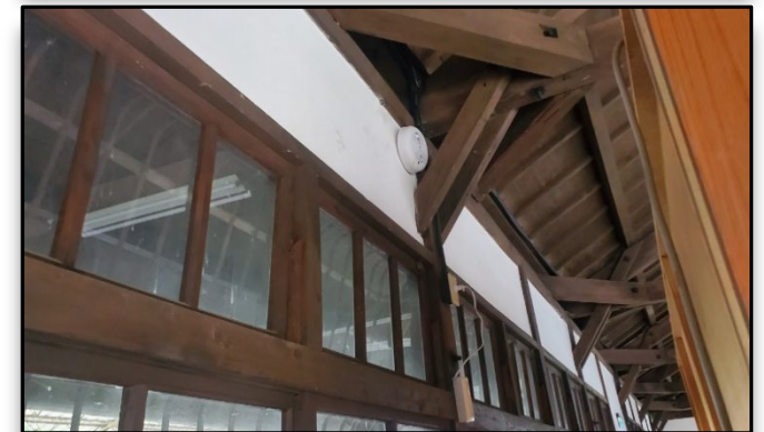
消防設備配管配線
