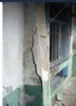
圖 24 看守所第二工場扶欄牆面毀
