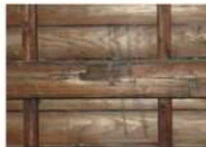
圖 9 材料不足時之傳統模式（第一工場上方屋架）
