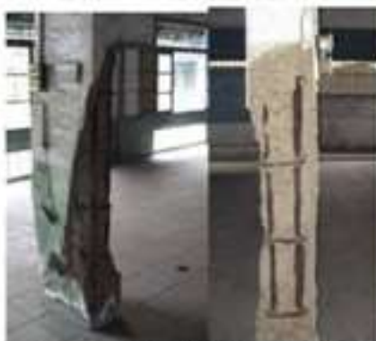
圖 27 水氣進入混凝土後，鋼筋腐蝕，保護層脫落
