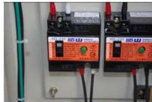
漏電斷路器設置
